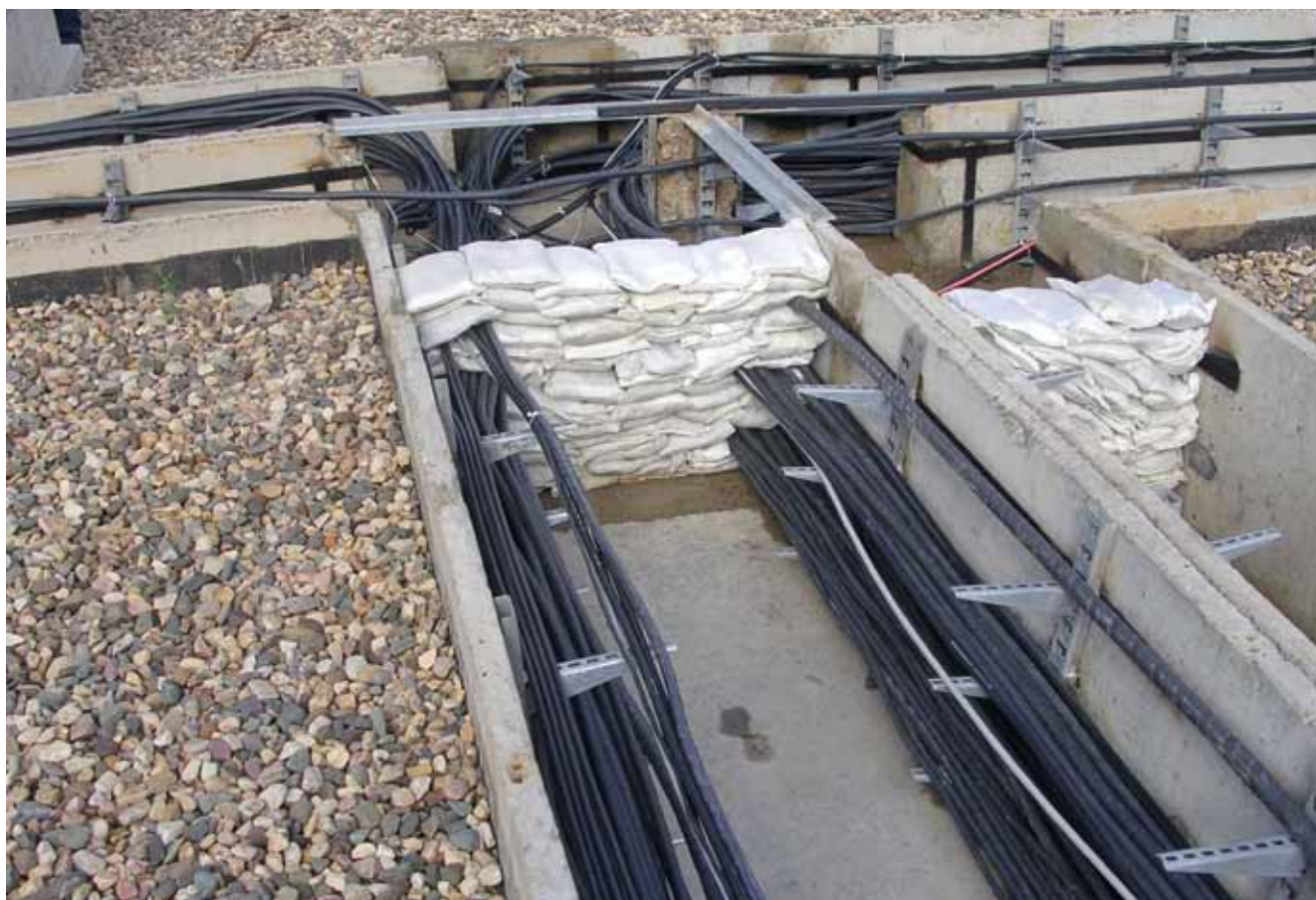
Рис. 5. Огнезащитная перегородка в заглубленном кабельном лотке и дополнительная шина заземления кабеленесущих конструкций
