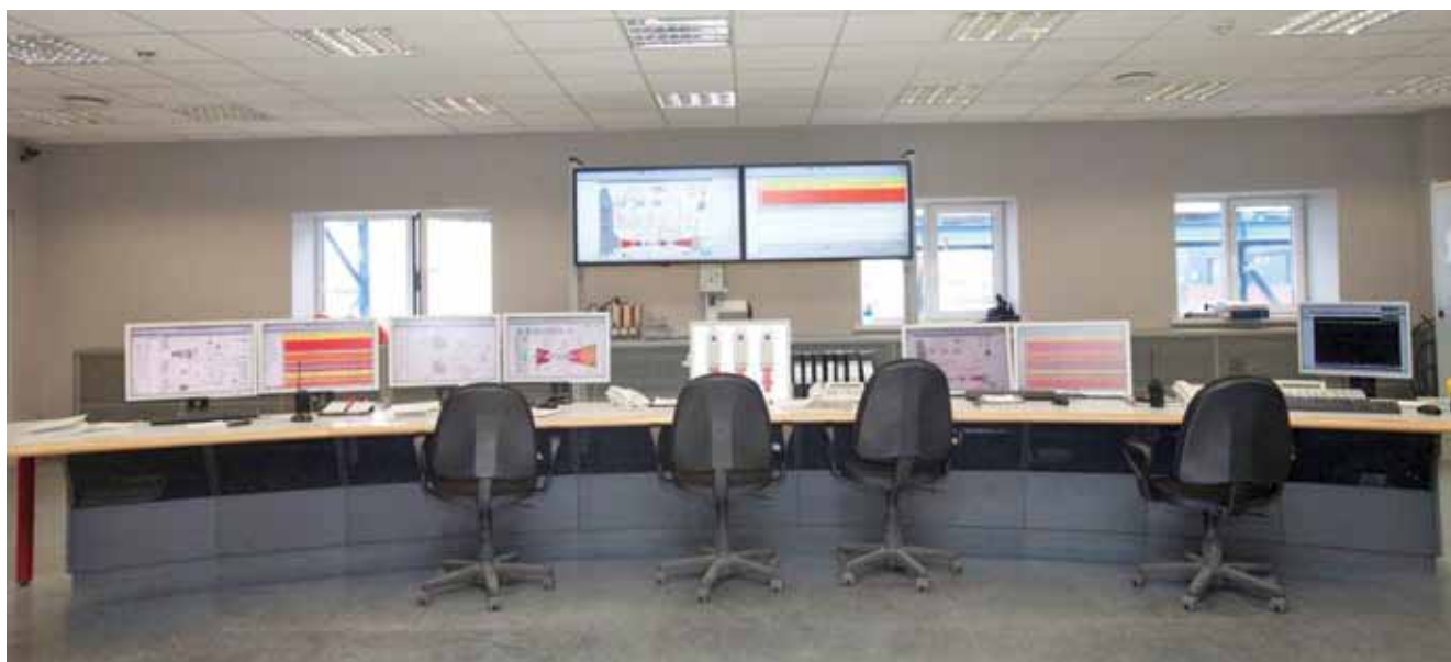
Новый главный щит управления ПГУ 420 МВт Яйвинской ГРЭС, филиал ОАО «Э.Он» Россия
