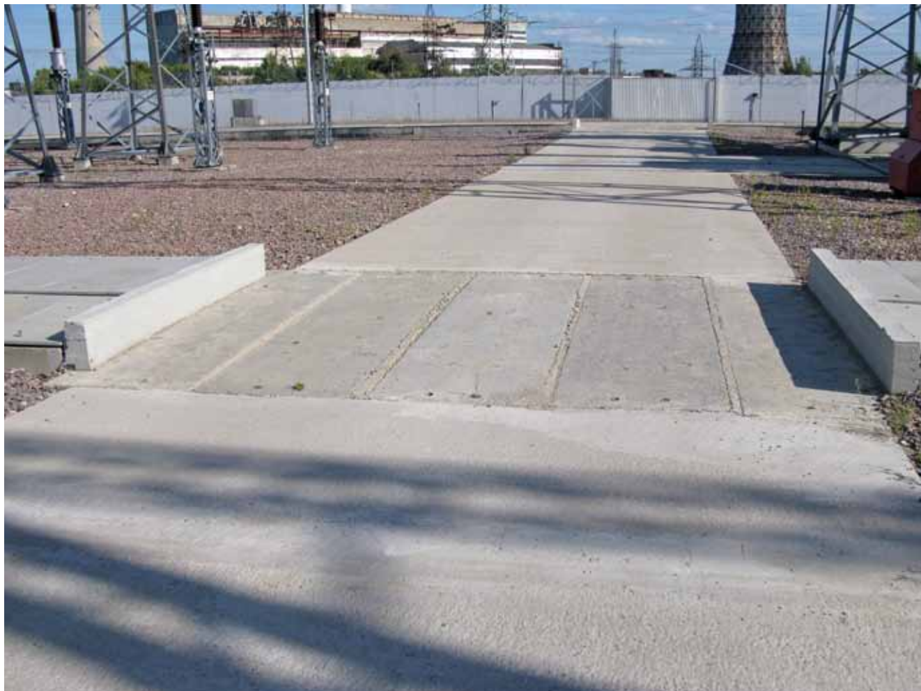
Рис. 1. Переезд через полузаглубленный кабельный канал
