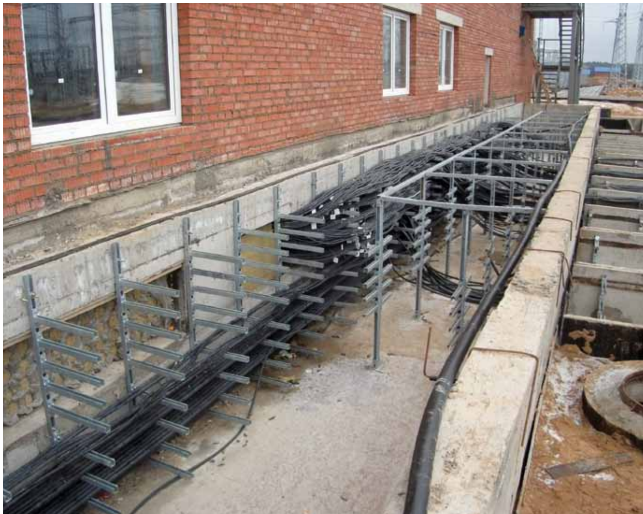
Рис. 3. Кабельная камера у наружной стены ОПУ. В данном случае представлено неудачное и тяжелое решение, затрудняющее дальнейшую эксплуатацию кабельного хозяйства
