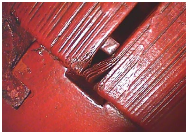
Рисунок 4. Повреждение пакета сердечника статора
