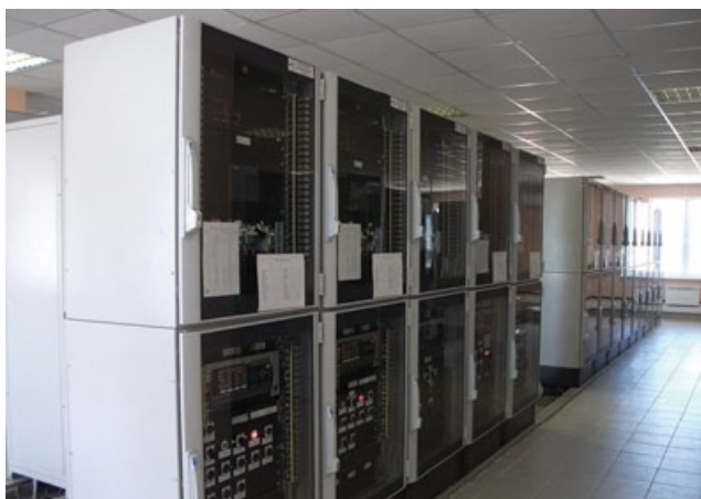
Современные шкафы релейной защиты и противоаварийной автоматики на ПС 500 кВ Кубанская
