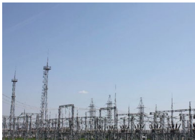
Подстанция 330 кВ Фрунзенская в работе
