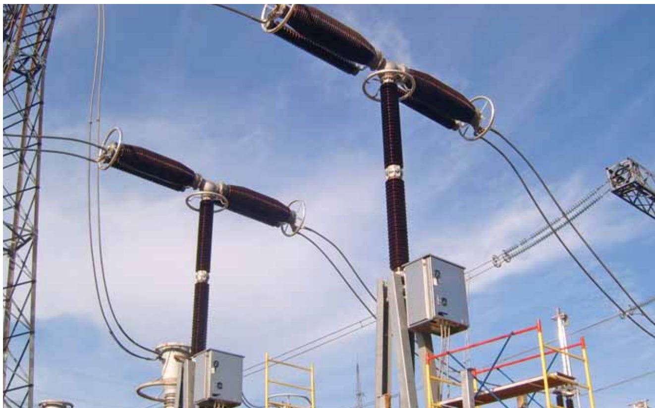
ПС «Калужская», ООО «ИНТЭКО»
